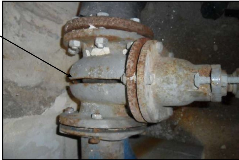
valvole intercettazione centrale termofrigorifera
