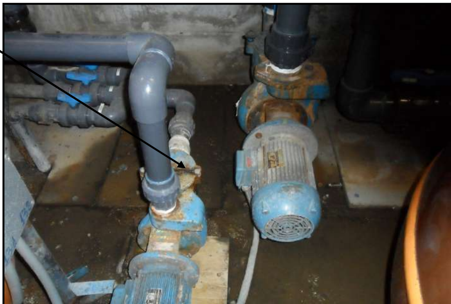
pompe centrale termofrigorifera
