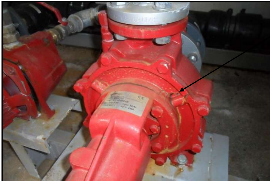
pompe centrale antincendio
