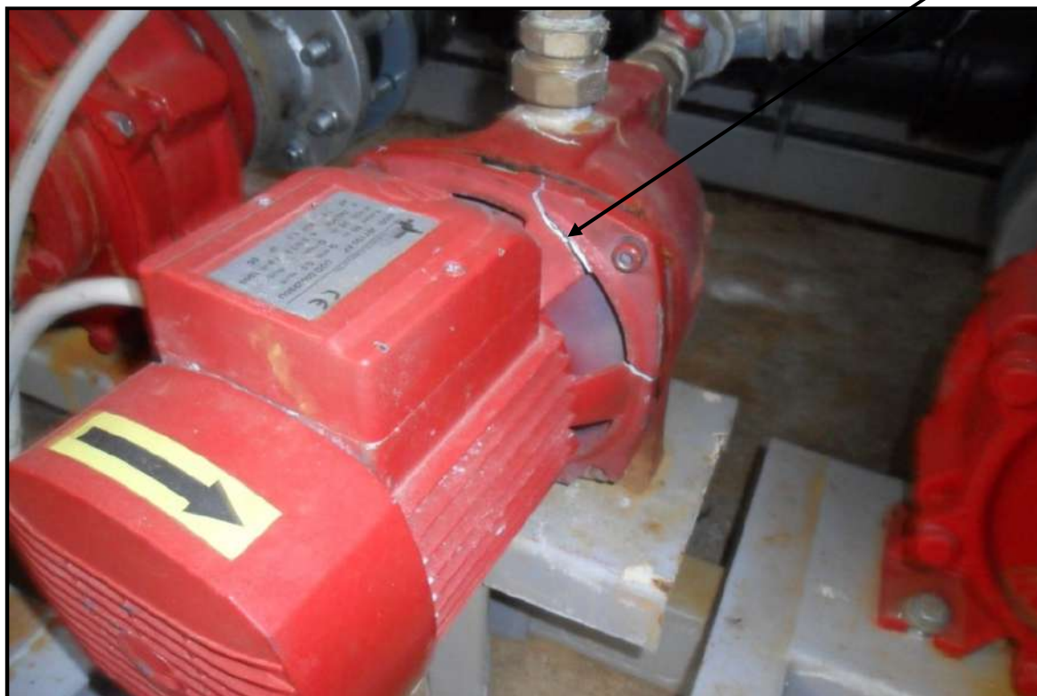
pompe centrale antincendio
