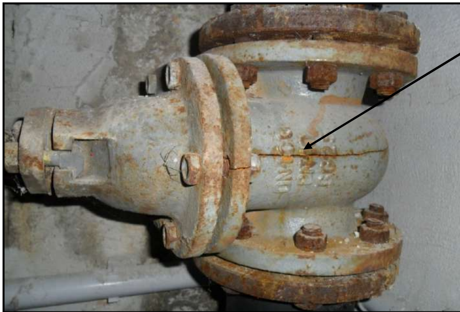
valvole intercettazione centrale termofrigorifera
